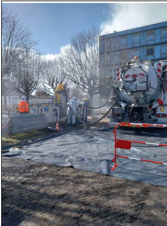
Nettoyage de l'unité de traitement d'eau
